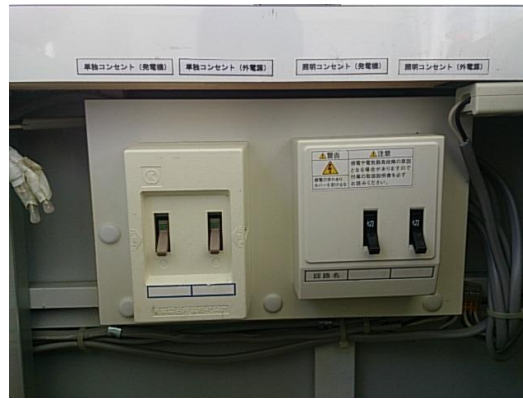
■ 電源ブレーカー
